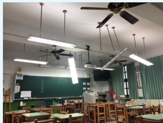
中華國小教室燈架脫落情況
