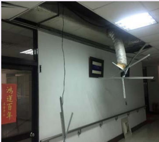
走廊天花板受損
