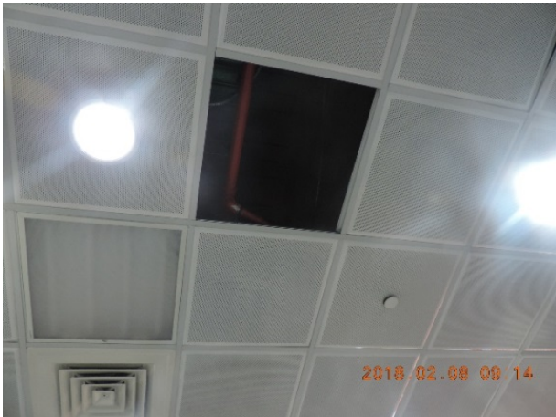
沖孔金屬天花上方消防撒水管漏水
