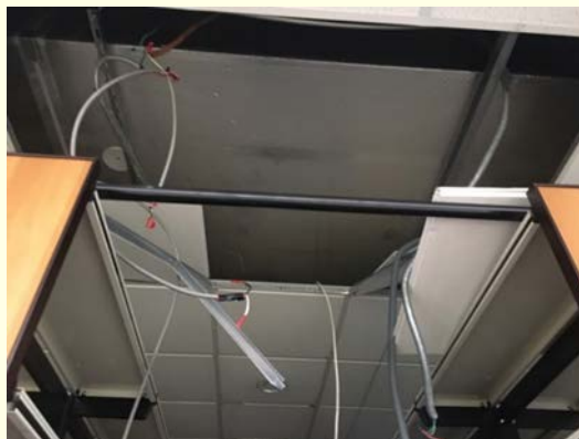
管線無吊線、燈具掉落
