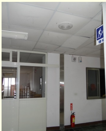
海星高中宿舍 天花板掉落
