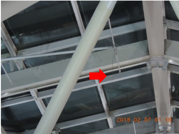
中庭挑空消防撒水管懸吊線鬆脫
