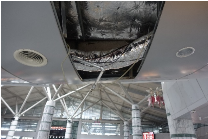
入境大廳消防撒水管震損向下折彎損壞漏水
