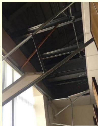
未正確設施吊線
