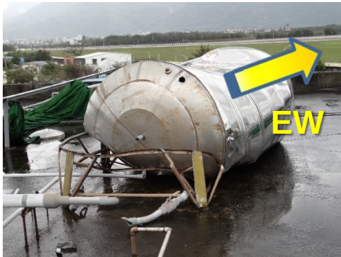
水塔傾倒水管斷裂
