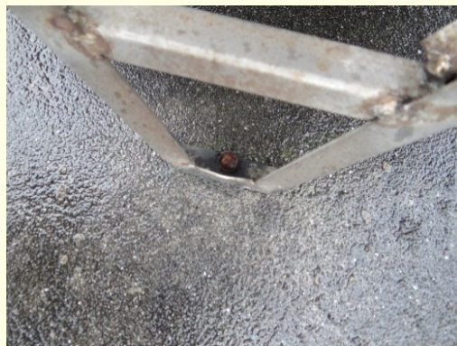
錨定情況(螺栓鏽蝕)
