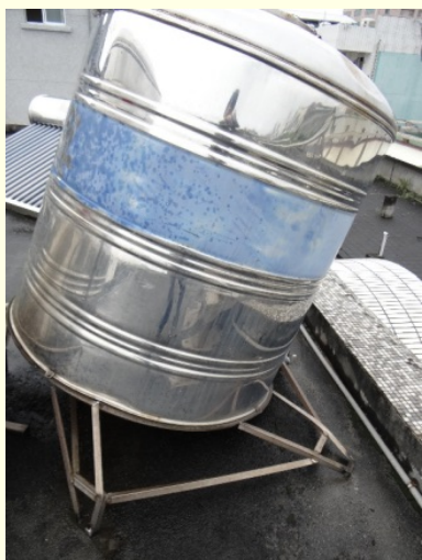
水塔支架變形
