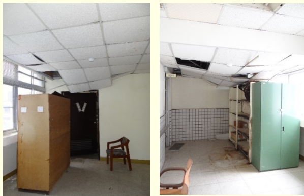
天花板系統末端鄰近牆面處破壞
