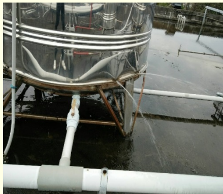
水塔底部變形漏水
